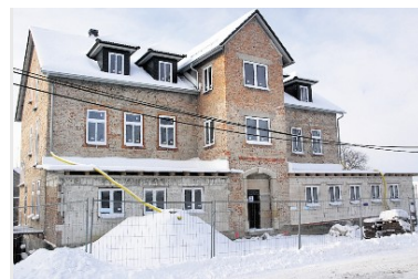
Neue Fenster wurden in der künftigen Kindertagesstätte bereits eingebaut, und auch der Außenputz ist abgeschlagen. Die Baufirmen stehen in den Startlöchern, um an der Einrichtung weiter zu bauen. Foto: Dirk Zschiedrich
